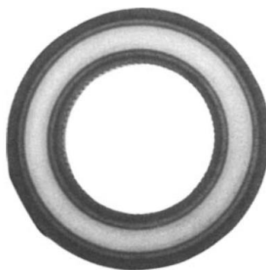
Obr. 3.17 Nauhličený vnútorný a vonkajší povrch ocelevej rúry
