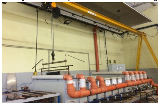
Obr. 3 Portálový žeriav na linku povrchových úprav
